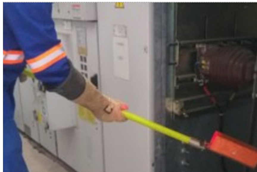
Figura 87 - Entrega dos ajustes de medidas protetivas da instalação elétrica do campus
